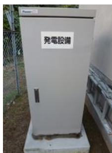
(非常用発電機の写真)
