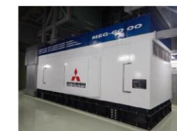
(常設代替交流電源設備の写真)
