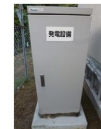
(非常用発電機の写真)
