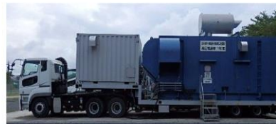
常設代替交流電源装置
