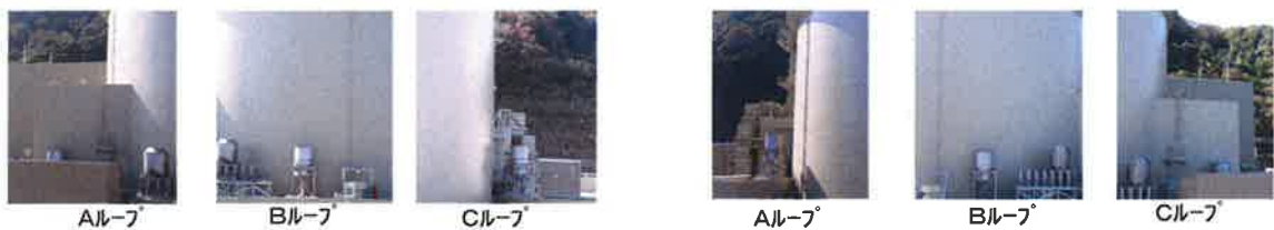
図3 主蒸気逃がし弁消音器の設置状況 (左3号炉、右4号炉 (各3系統))
