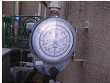
図1 復水タンク水位計
