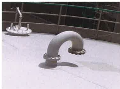
図2 復水タンクベント管
