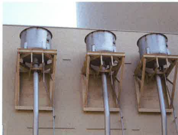
図3 主蒸気逃がし弁消音器の設置状況
