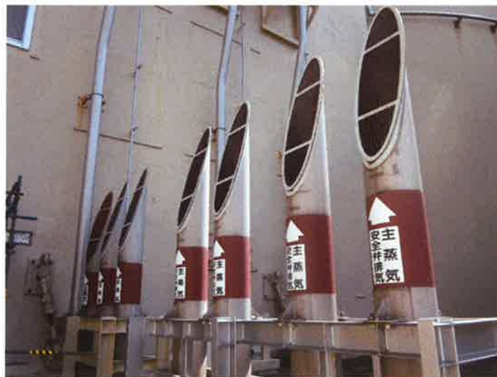
図3 主蒸気安全弁（排気管）の設置状況
