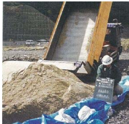
埋戻土(購入土) 現地写真(H11年)
