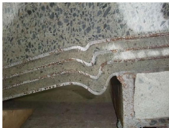
圧縮縁はらみ出し状況
