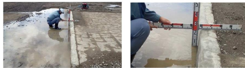
復旧前の段差状況
