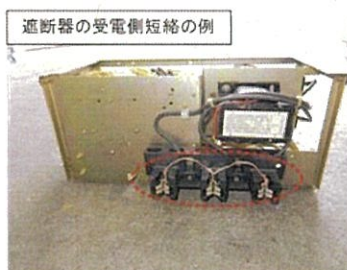
図 4.5.3 遮断器の短絡箇所 (C/C 試験時)
