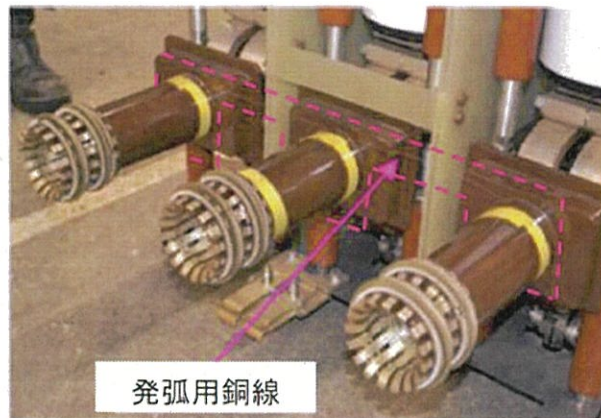
発弧線の設置状況 (遮断器 2 次側端子)
