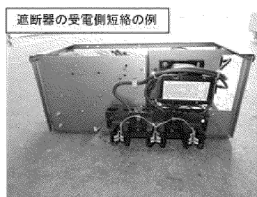
図 4.5.3 遮断器の短絡箇所 (C/C 試験時)
