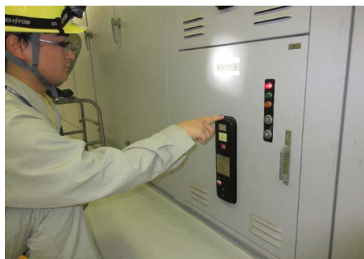
不要負荷切離し（遮断器）
