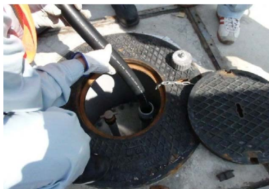
可搬型設備用軽油タンクへのホース挿入
