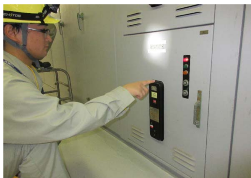
不要負荷切離し（遮断器）
