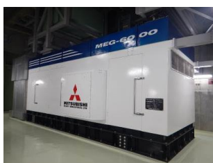
(常設代替交流電源設備の写真)
