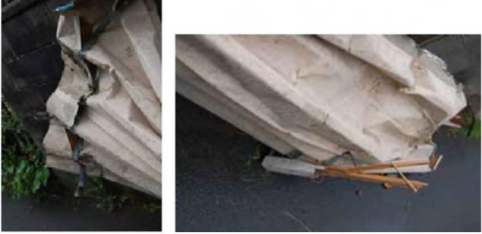
飛散した折板屋根の状況
