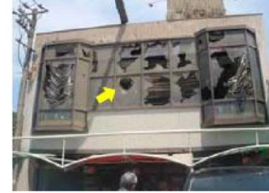
写真3.4-22 店舗の窓ガラスの被害状況
