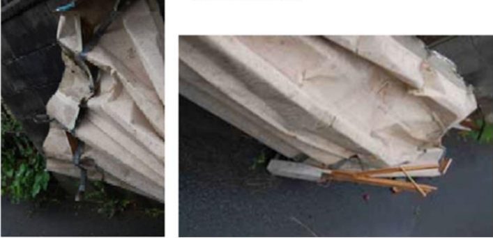
飛散した折板屋根の状況
