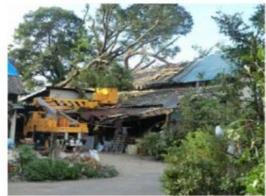
樹木の倒壊による小屋組の被害
