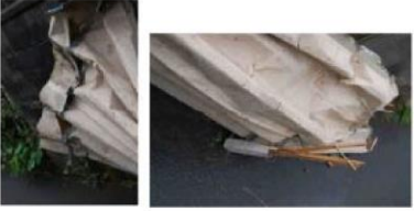
飛散した折板屋根の損傷状況
