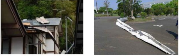
飛来物 (鋼板製屋根材) の衝突
