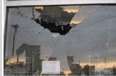
写真3.4-35 ガラスへの飛来物の衝突痕
