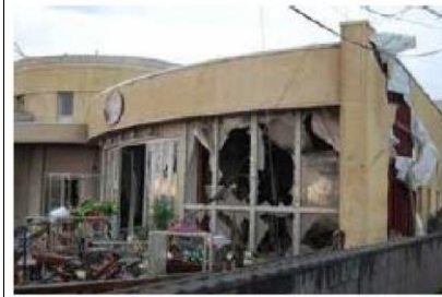
写真3.4-21 店舗の窓ガラスの被害状況
