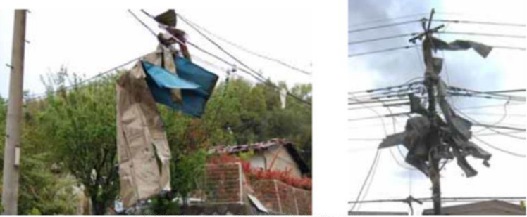
電線等に引っ掛かった飛来物 (鋼板製屋根材)
