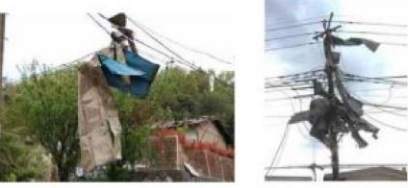
電線等に引っ掛かった飛来物 (鋼板製屋根材)
