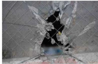
ガラスの被害状況(飛来物衝突痕)
