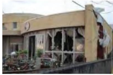
店舗の窓ガラスの被害状況
