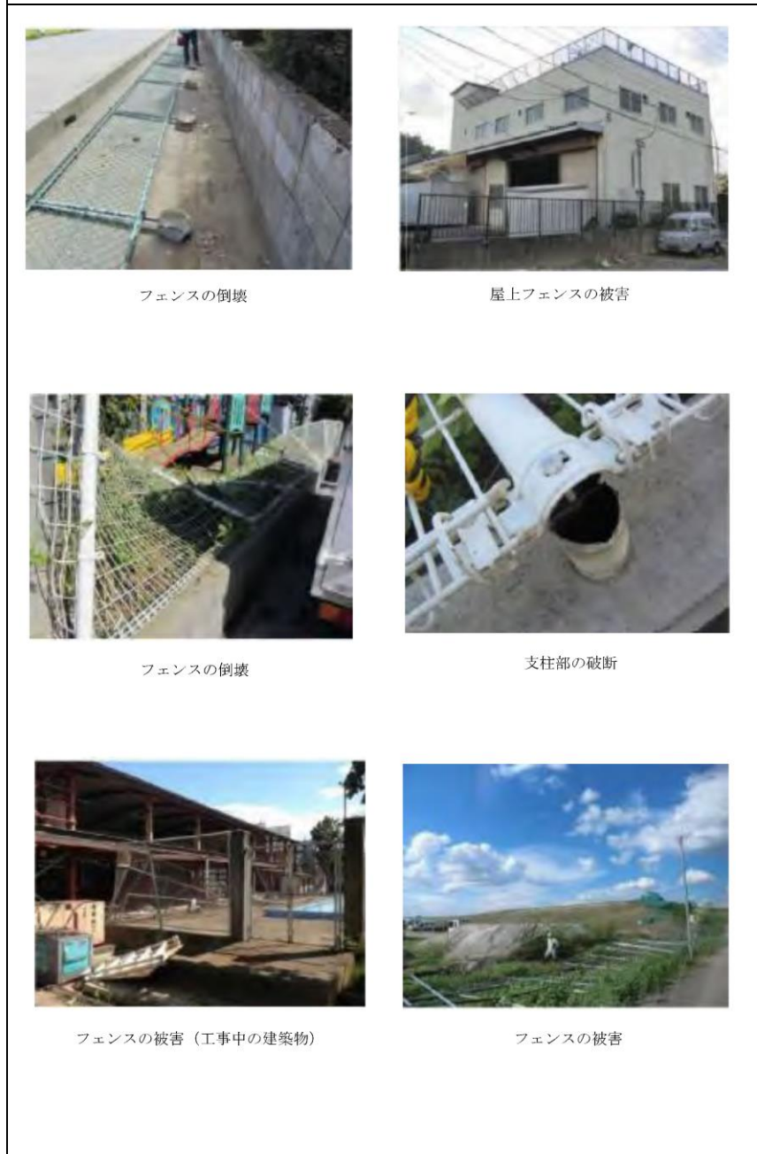
図 31 平成 25 年 9 月 2 日埼玉県発生した F2 竜巻によるフェンスの被害状況 (8)
