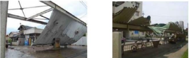
ガソリンスタンドの折板屋根の脱落
