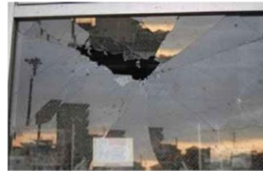
ガラスの被害状況(飛来物衝突痕)
