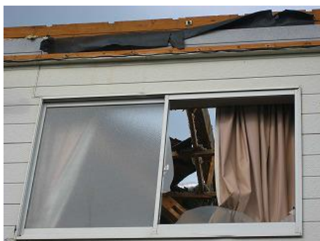
写真 19 窓ガラスの損壊
