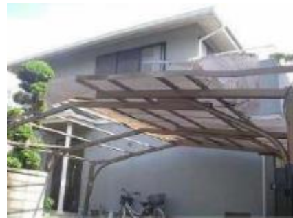
カーボードの被害
