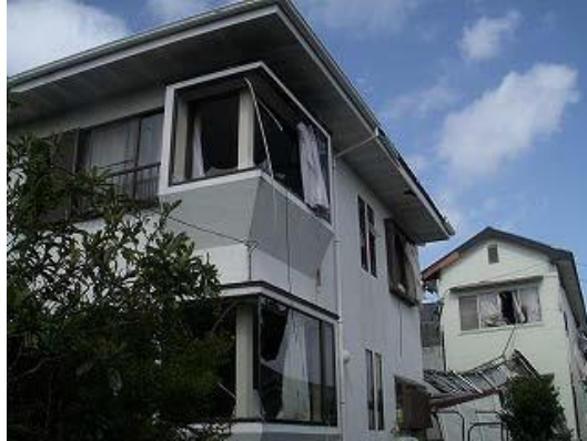
写真 30 出隅部の窓ガラスの被害
