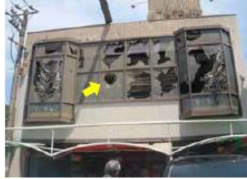
写真 3.4-22 店舗の窓ガラスの被害状況
