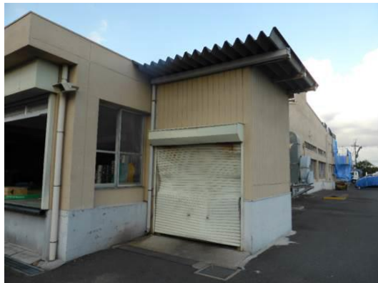
写真 4.1.30 シャッターの変形
