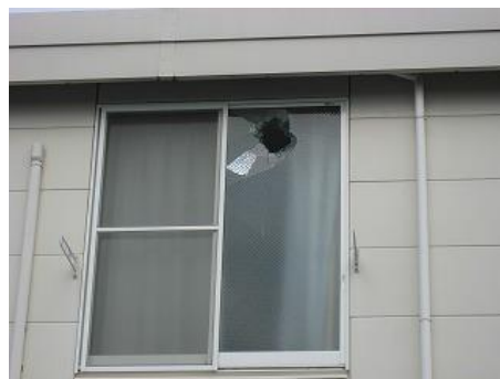
写真 27 窓ガラスの飛来物衝突痕
