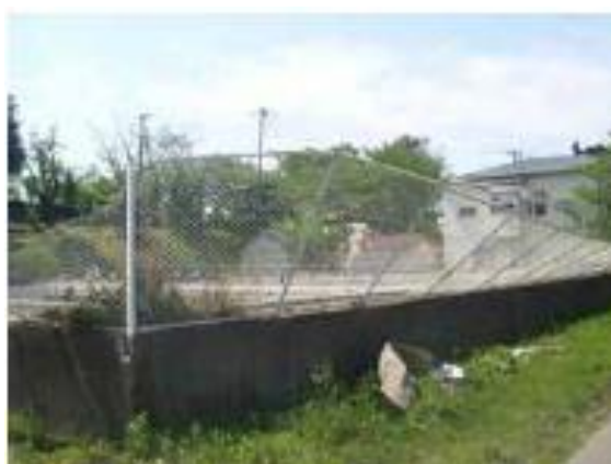
写真3.5-10 フェンスの被害状況
