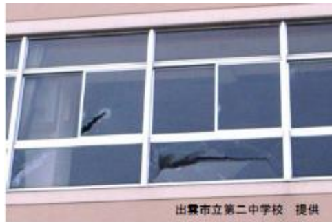
写真 3 体育館窓ガラスの破損
