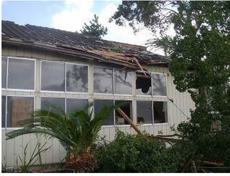
写真 8 倉庫の窓ガラスと屋根の被害状況
