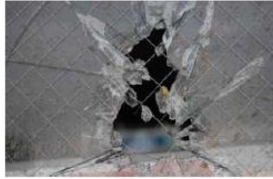
写真 3.4-36 ガラスへの飛来物の衝突痕
