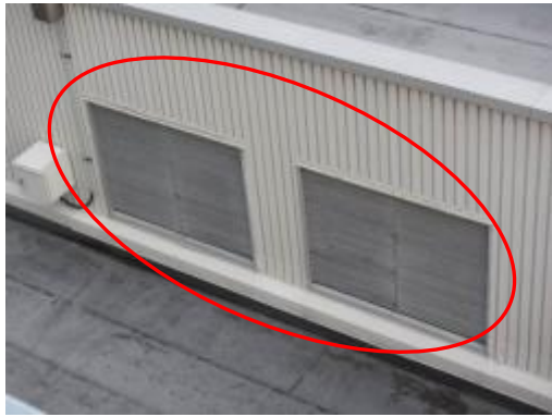
9 1号中央制御室空調換気系給気用格子
