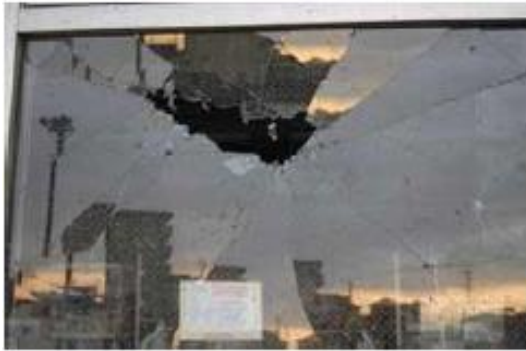
写真 3.4-35 ガラスへの飛来物の衝突痕
