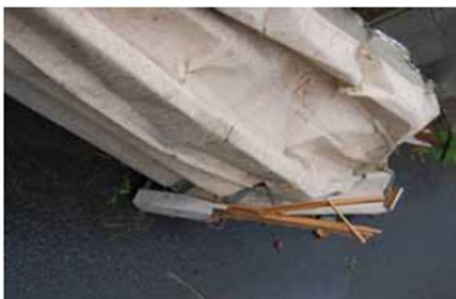
飛散した折板屋根の状況
