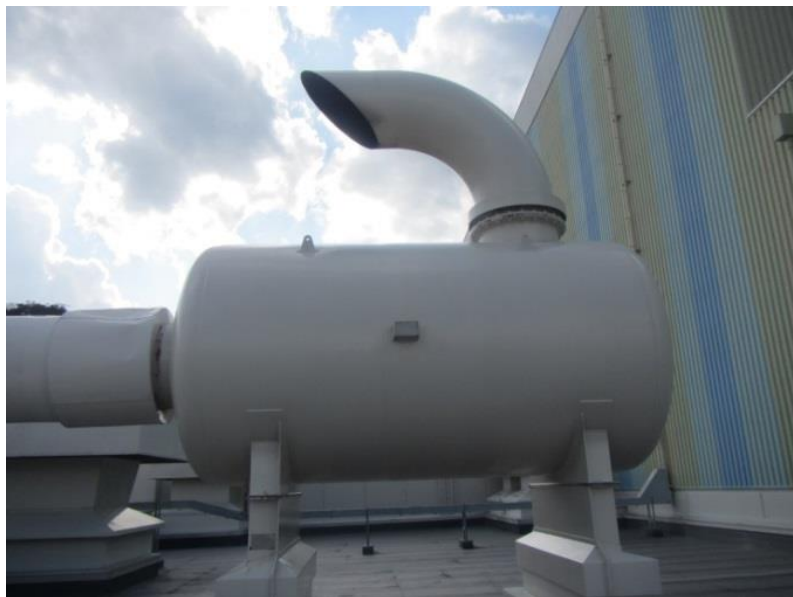
図9 非常用ディーゼル発電機排気消音器及び排気管
