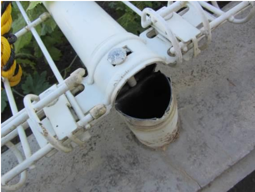
写真 4.1.15 支柱部の破断
