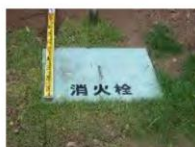
③-10 消火栓蓋
