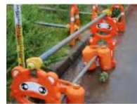
③-2 鋼製車止め (単管バリケード)
