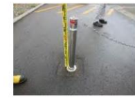
④-13 鋼製止め
