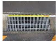
④-2 グレーチング
