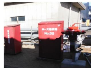
#153 消防設備格納箱
