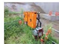
③-3 仮設分電盤
