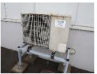
④-14 空調室外機
