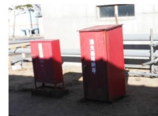
#152 消防設備格納箱
