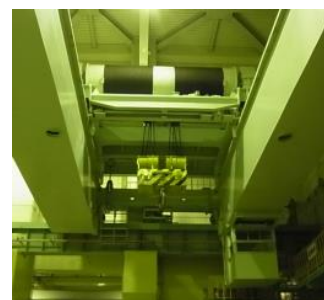
原子炉建物天井クレーン
