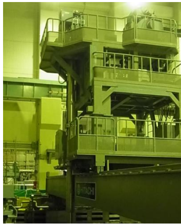
燃料取替機（トロリ）外観
