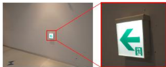
通路誘導灯 (廊下・通路)
