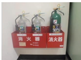
消火器設置状況
