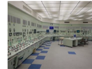
非常用交流照明点灯時
