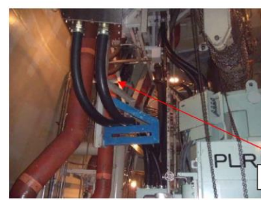
機器へのケーブル取合状況 (PLRとの取合)
