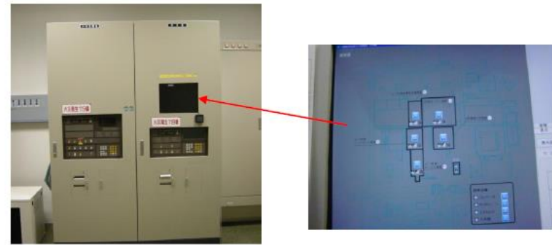
〈火災受信機盤・防災盤〉
