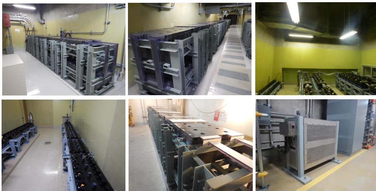
第1-39図 蓄電池の設置状況 (1 / 7)
