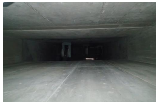
B-給気消音器フィルタ室内
