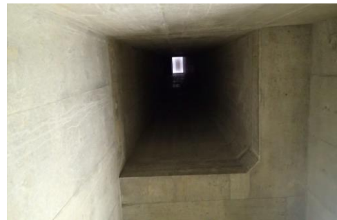
A-給気消音器フィルタ室内
