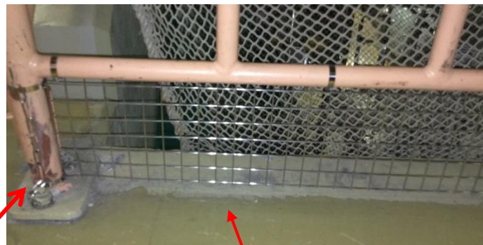
トゥープレート部は溢水が流れやすいように加工
