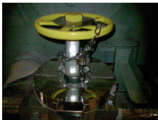
原子炉浄化系原子炉压力容器ドレン弁
