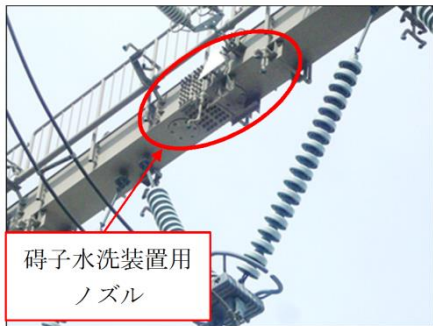
220kV 送電線（開閉所出口）
