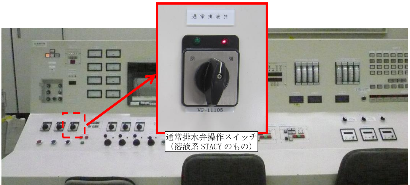
監視操作盤(運転者席)の計器配置及び通常排水弁の操作スイッチ
