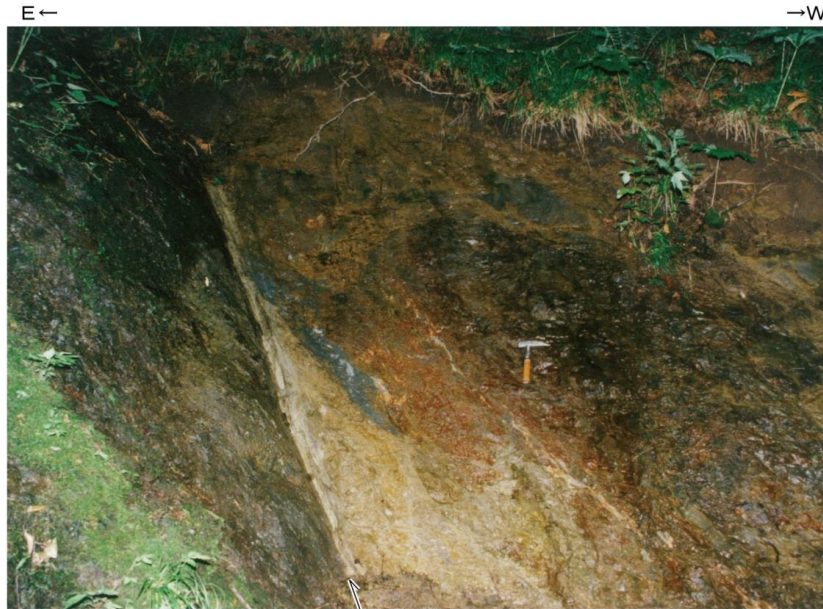
Loc. u349 東通村老部川支流 東側の泊層凝灰角礫岩と西側の蒲野沢層泥岩とを境する断層。 断層面沿いには軟質粘土を伴う。
