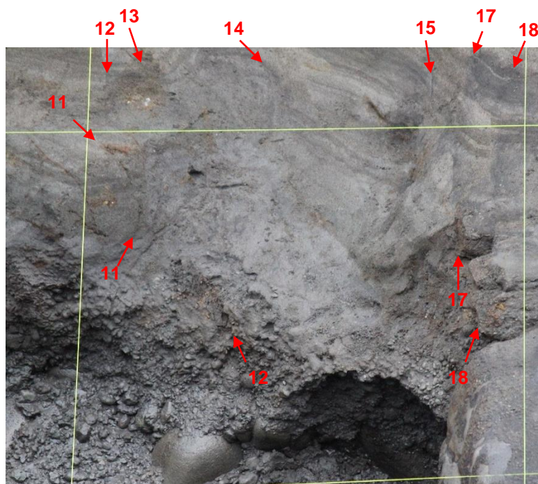
② 小断裂11~18 小断裂は砂層と礫層の境界あるいは礫層中で不明瞭となる。
