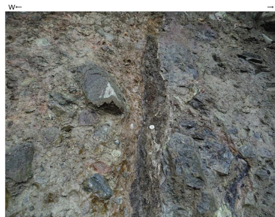
同上拡大 断層面沿いには幅5~10cmの細片状セピオライトがみられる。
