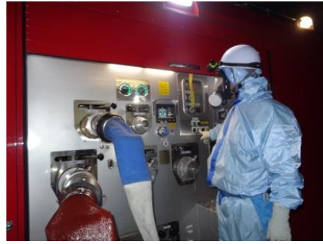
ポンプ起動操作（夜間）
