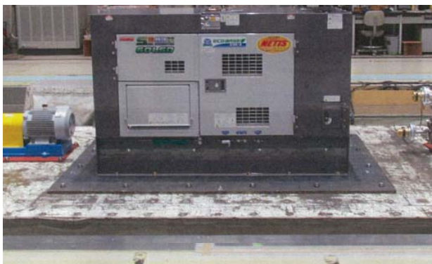
可搬型発電機
