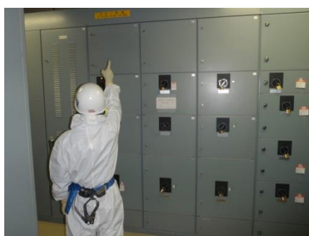
電源開放操作
