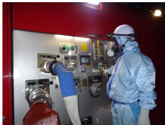
ポンプ起動操作（夜間）
