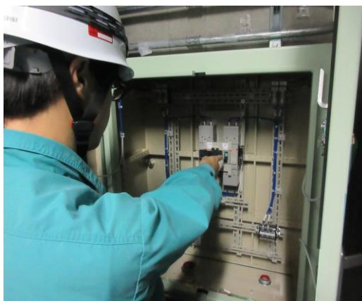
電源切替操作
