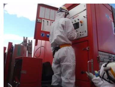
ポンプ起動操作
