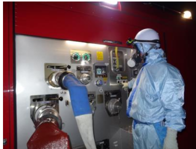
ポンプ起動操作（夜間）
