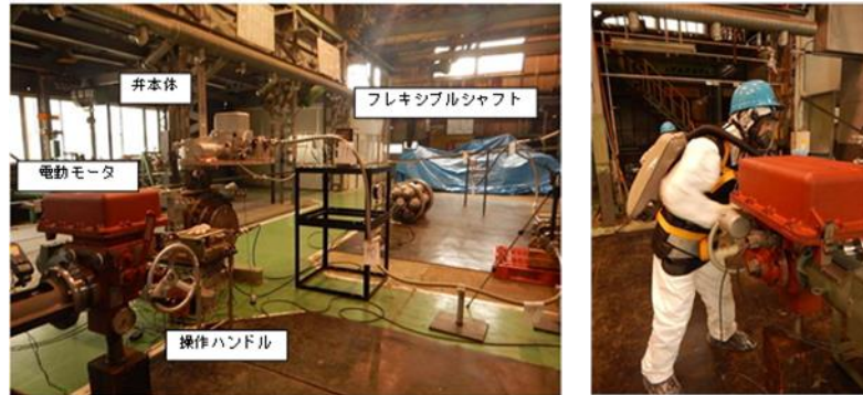
ベント操作（遠隔手動弁操作機構）
