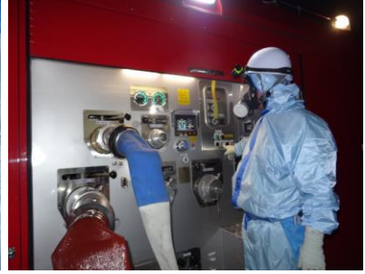
ポンプ起動操作（夜間）
