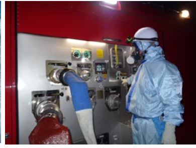
ポンプ起動操作（夜間）
