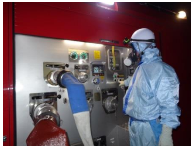
ポンプ起動操作（夜間）
