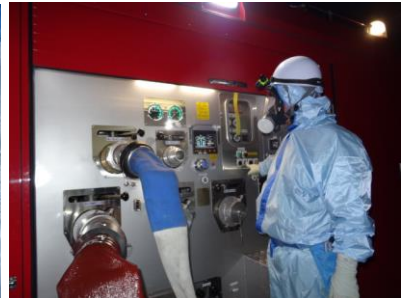
ポンプ起動操作（夜間）
