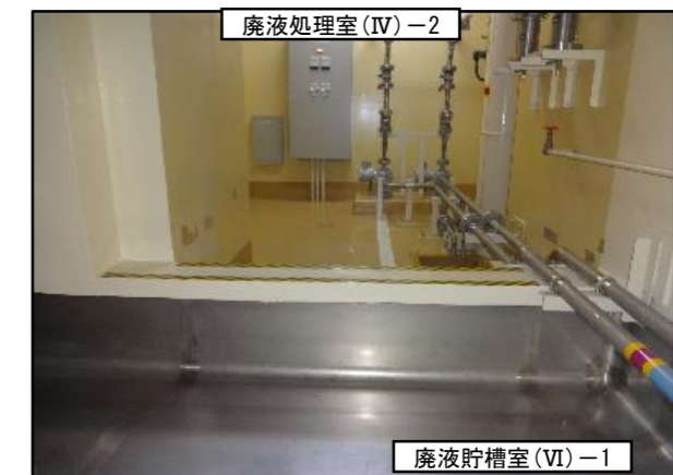
廃液処理室(IV)-2 【写真①】
