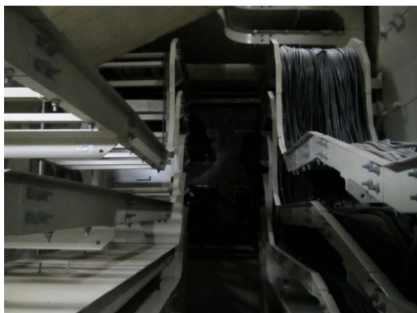
図 2. 4 ① ケーブルダクト室内 MCT 付近
