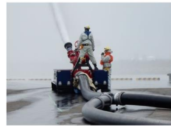
放水砲による放水 (直状放射)
