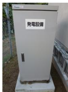
(非常用発電機の写真)
