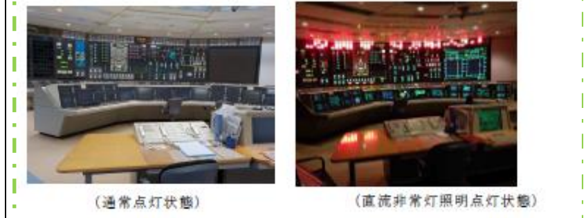
図 2.5-5 非常灯照明下で中央制御室の状況
