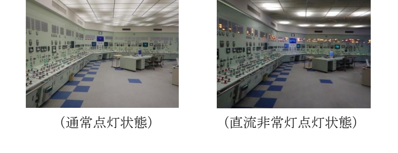
図 2.5-4 直流非常灯照明下での中央制御室のイメージ (シミュレータの点灯例)
