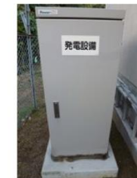
(非常用発電機の写真)
