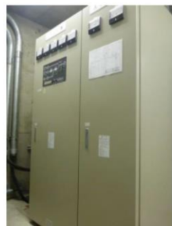
(無停電電源装置の写真)
