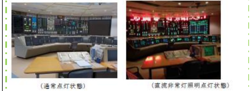
図 2.5-5 非常灯照明下で中央制御室の状況
