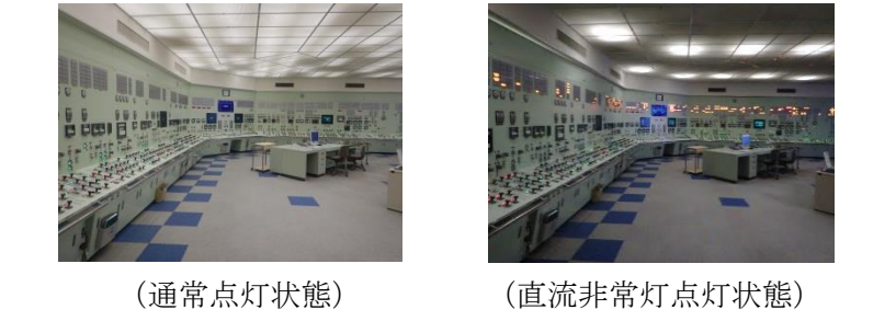
図 2.5-4 直流非常灯照明下での中央制御室のイメージ (シミュレータの点灯例)
