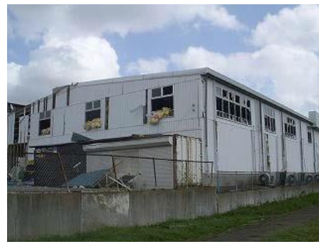
写真 16 窓ガラスの破損
