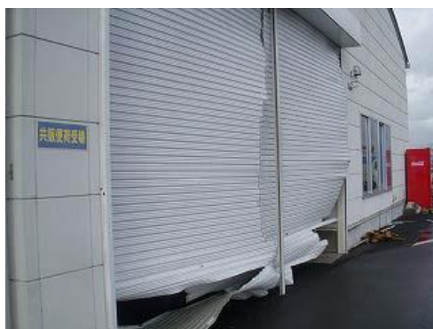
写真 10 シャッターの破損
