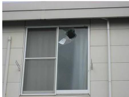
写真 27 窓ガラスの飛来物衝突痕
