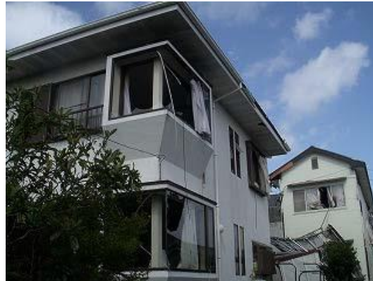
写真 30 出隅部の窓ガラスの被害
