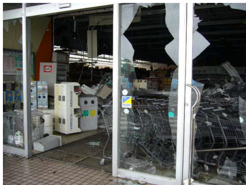
写真 8 エントランスの窓ガラスの破損
