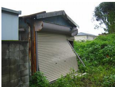
写真 22 シャッターの外れ
