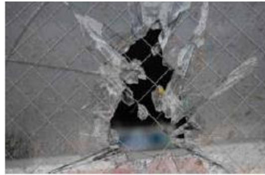
写真 3.4-36 ガラスへの飛来物の衝突痕
