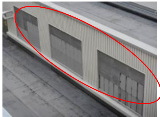
10 1号R/B空調換気系給気用格子
