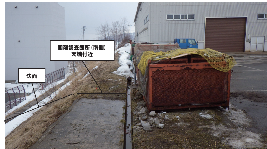
写真② 開削調査箇所(南側)付近法肩状況(H25年3月撮影)
