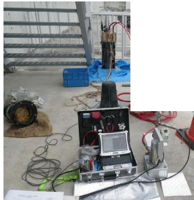
防波壁（鋼管杭式逆T擁壁）定期点検状況 （リフトオフ試験）
