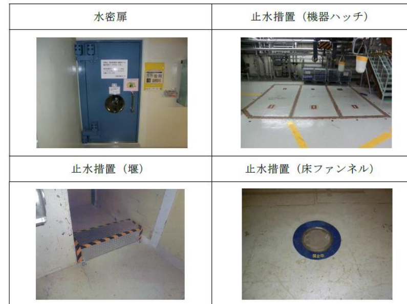
第4図 既設浸水防護対策（例）
