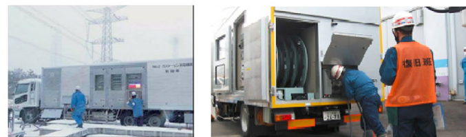
代替交流電源設備（ガスタービン発電機車、電源車）の接続訓練
