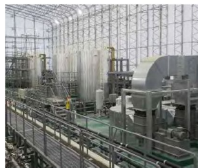
処理水タンク・供給タンク
