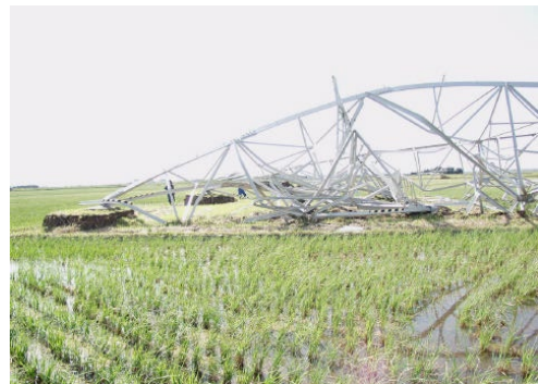
強風による送電鉄塔の倒壊事例② ※1
