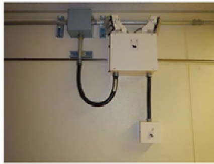
第7図 電源内蔵型照明
