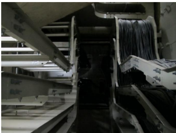
図 3. 4 ① ケーブルダクト室内 MCT 付近
