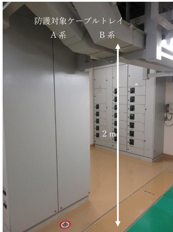
図2 原子炉建家地階の防護対象ケーブルトレイ（最も低い箇所）
