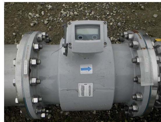
可搬型放水砲流量計
