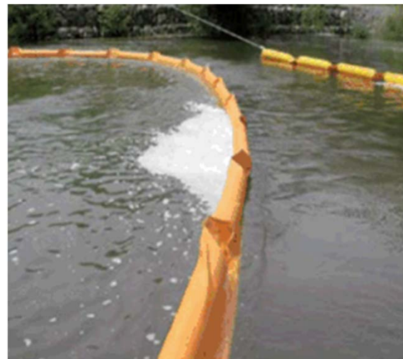
可搬型汚濁水拡散防止フェンス
