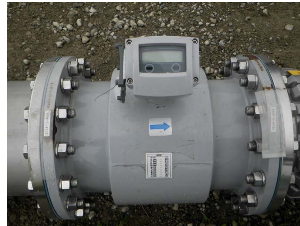
可搬型第1貯水槽給水流量計
