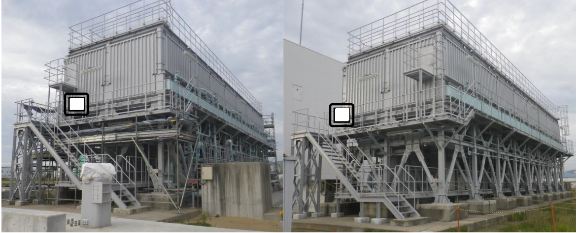
16. G10 非常用電源建屋 冷却水設備：冷却塔A/B
