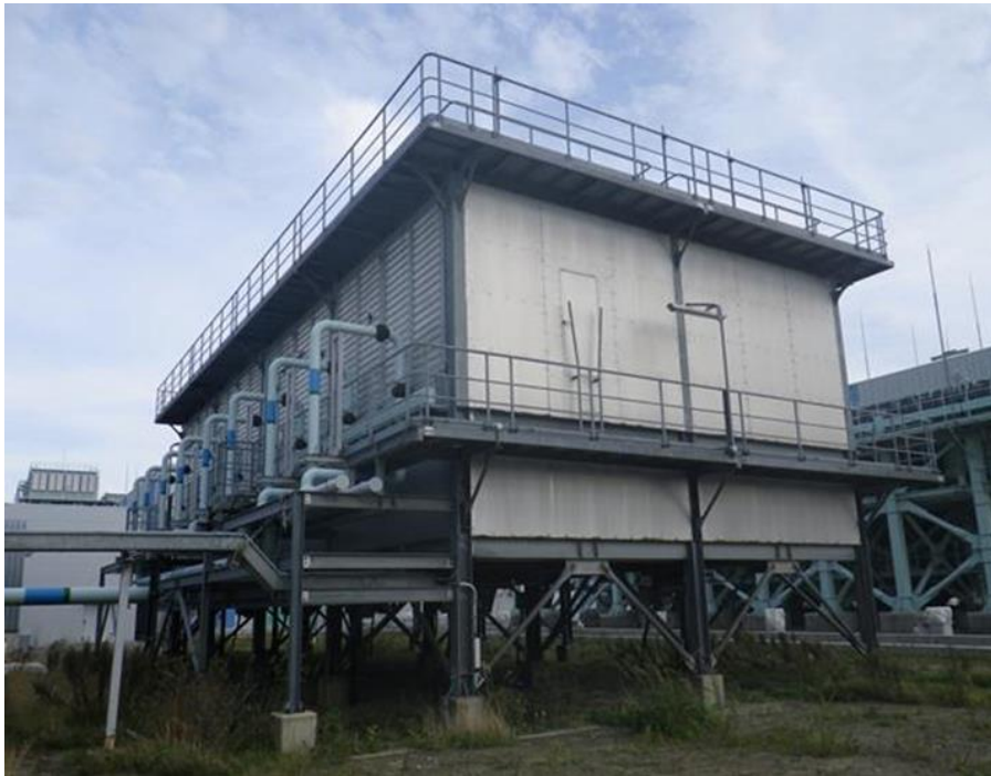
10. G 9 運転予備用冷却水設備：冷却塔
