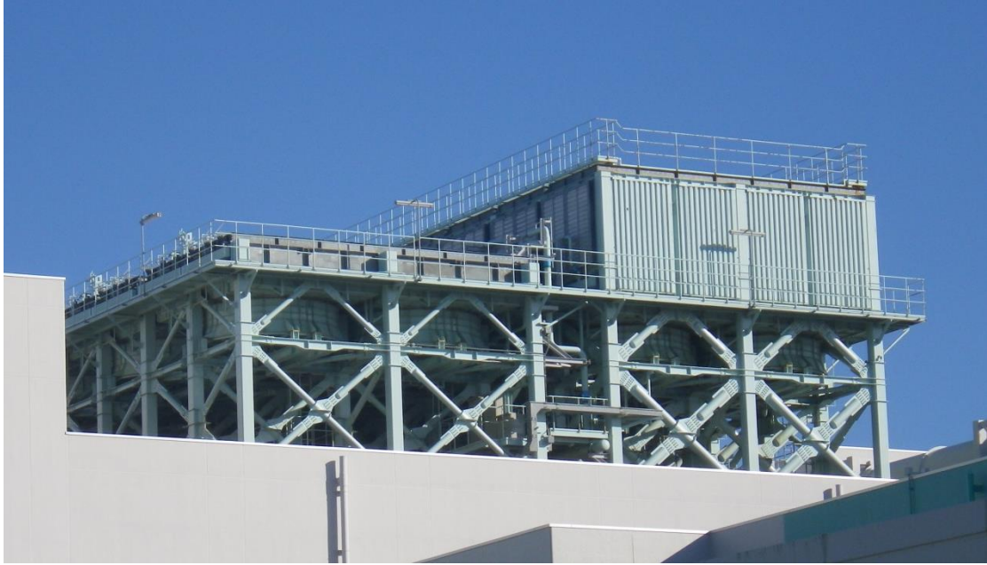
17. 冷却水設備：安全冷却水A冷却塔 (前処理建屋北東地上へ移設予定)
