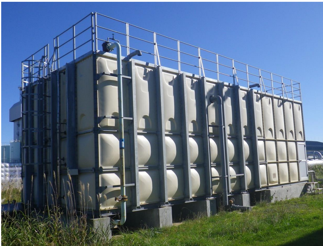
3. G2 常用冷却水設備：散水用水貯槽
