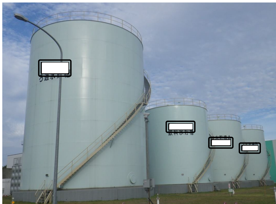
6. G 6 工業用水施設：ろ過水貯槽，飲料水貯槽，純水貯槽 A/B
