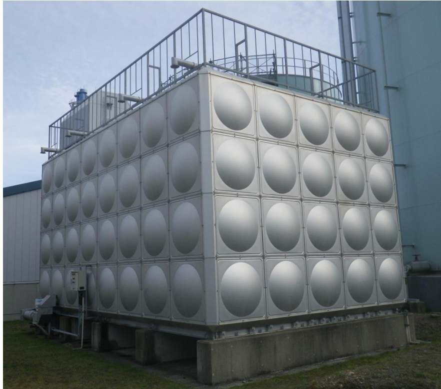
7. G6 工業用水施設：飲料水増設貯槽
