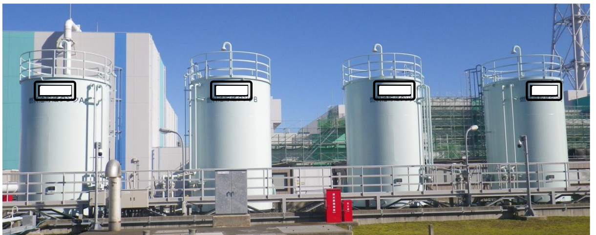
8. G7 ディーゼル発電機設備用燃料油受入れ・貯蔵所：
