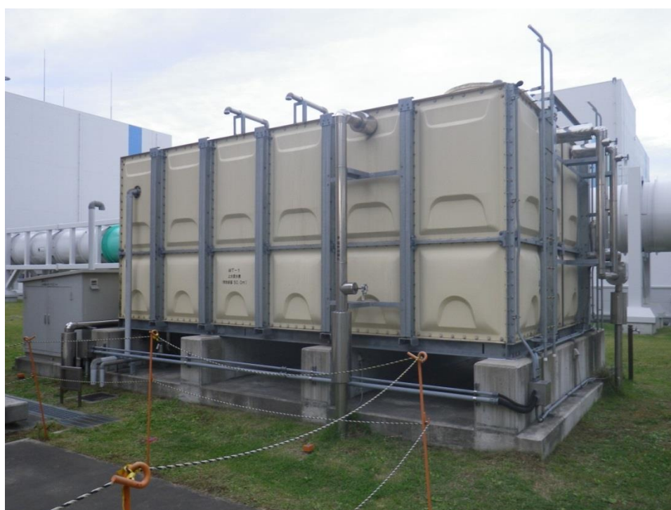
15. H2W 再処理事務所 西棟：受水槽
