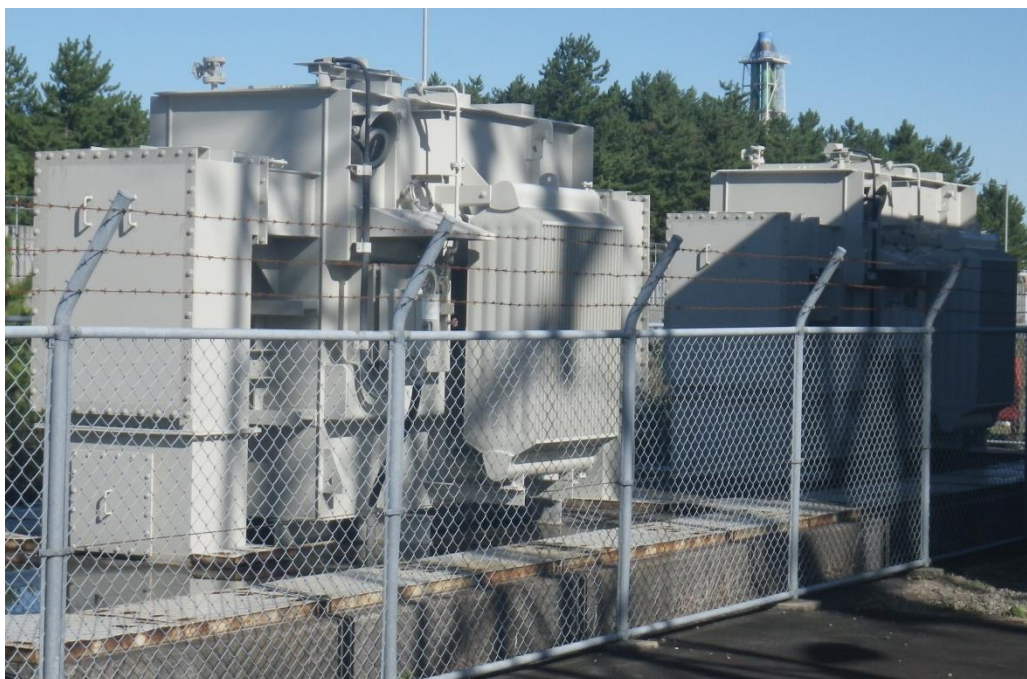
1. G 1 開閉所：構内電源設備限流リアクトルD1/D2
