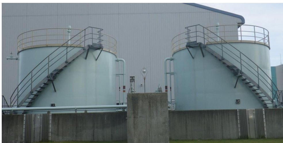
5. G 4 ボイラ用燃料貯蔵所：燃料油サービスタンク A/B
