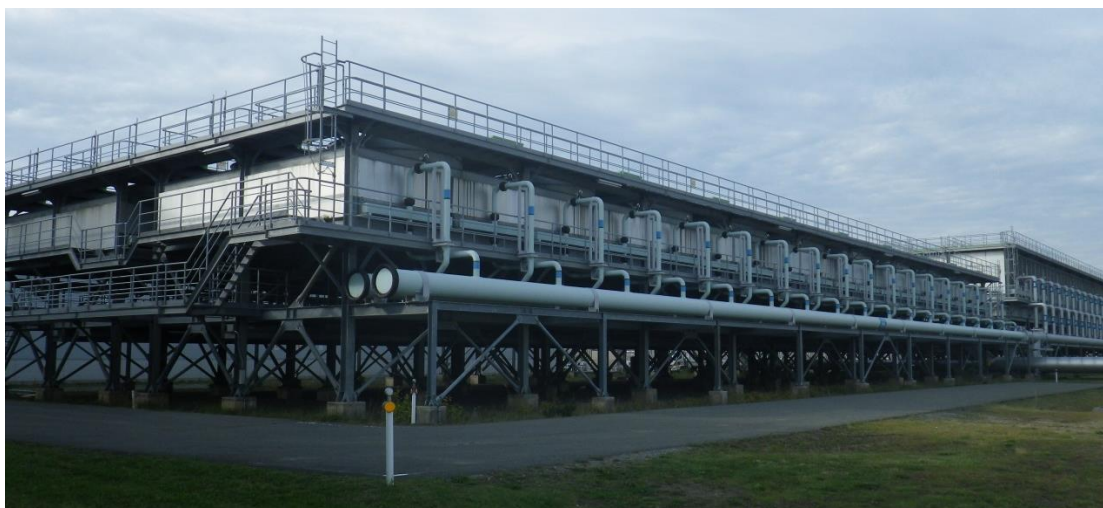
2. G 2 常用冷却水設備：冷却塔
