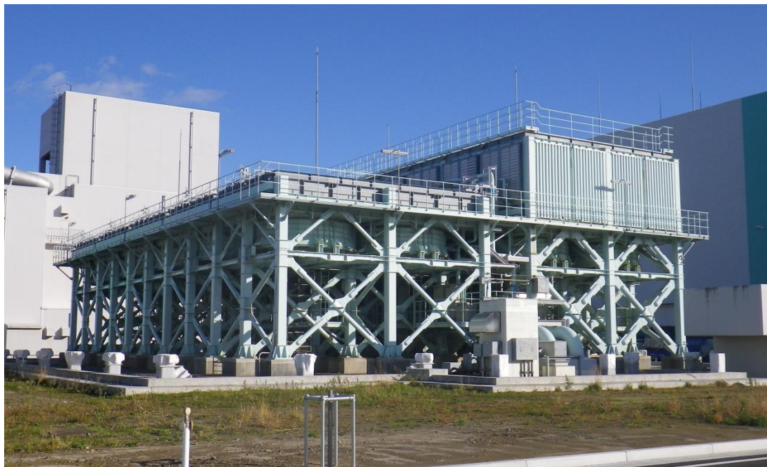
18. 冷却水設備：安全冷却水B冷却塔
